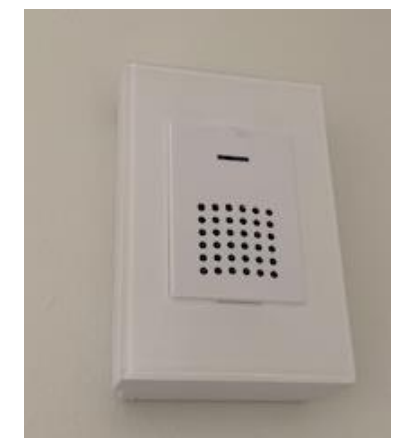
Batterier skal skiftes i ringetryk og ringeklokke når det kræves
